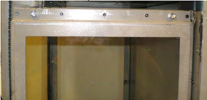
Haut du cadre de la porte vitrée
